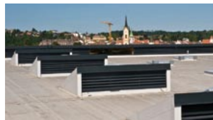
Die Profile der Lüftungsgitter sind mit anorganischer Mineralwolle gefüllt.
